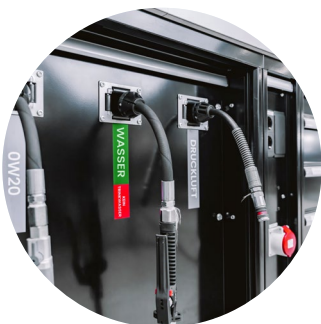
Armarios con cajones con suministro de medios
