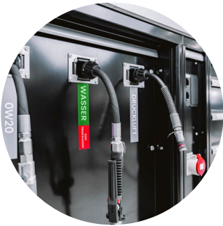
Schubladenschränke mit Medienversorgung
