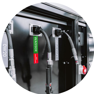
Skříně se zásuvkami s napájením médií
